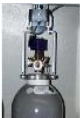
Centrale de pesage et électrovanne CO 2
